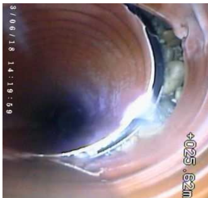
kanal T 1 - przykanalik przerwanie ciągłości kanału 25,62 od studni T 1 20 cm zewnętrznej strony ściany hali
